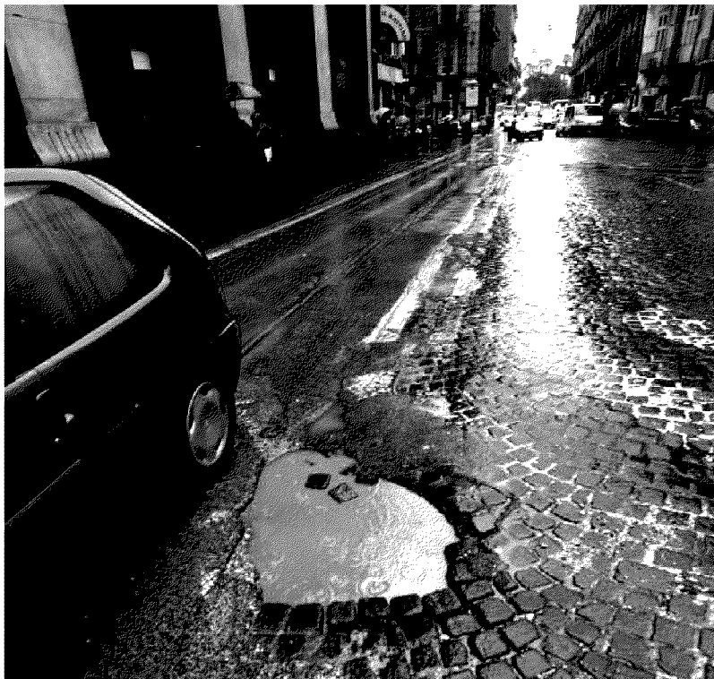
Una delle tante buche in una strada centrale della città
